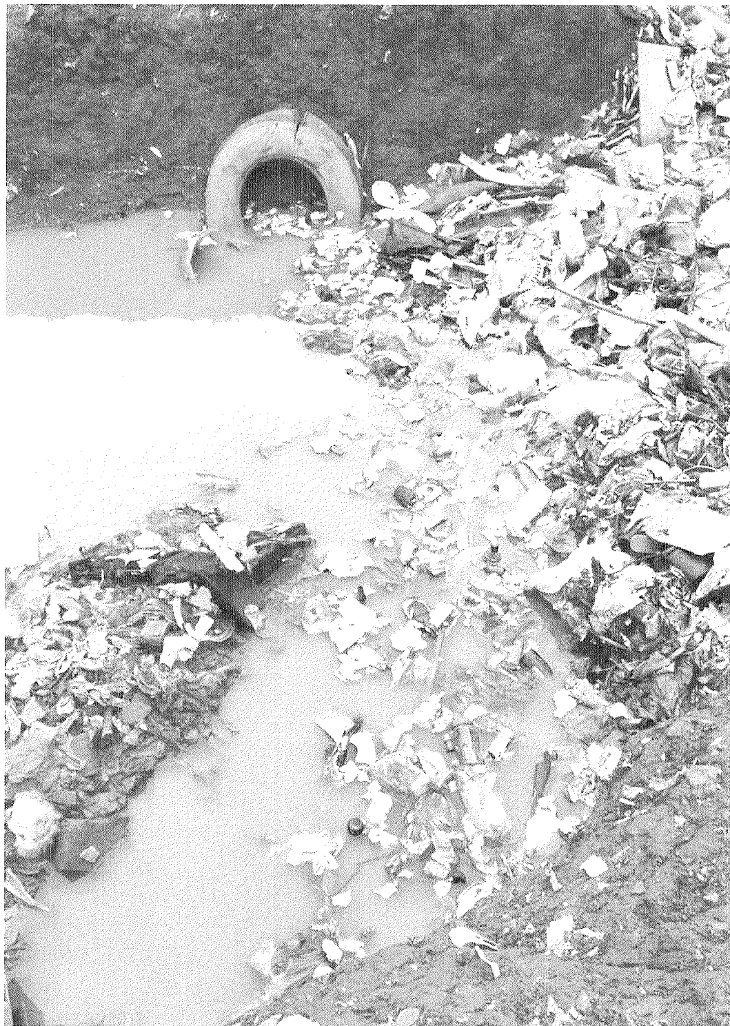
Figura 02: Situação dos resíduos após período de chuva.
